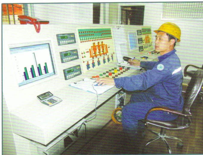
自动配料控制室 Auto Scale Control Room
